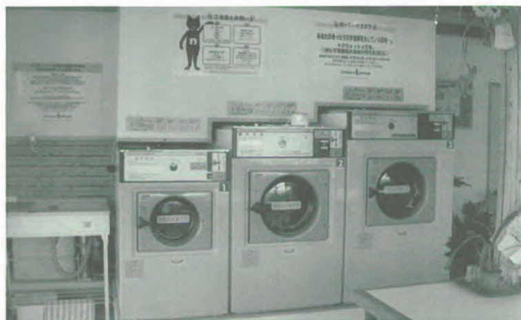
室内はムク材をふんだんに使った気持ちのいい空間になっている。洗濯機はすべてスウェーデンのエレクトロラックス社製。
